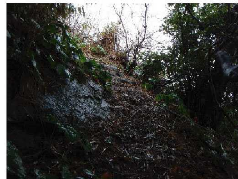
①傾斜が急な上、土砂や枝葉が階段に堆積し、また踏面が傾いているところもあり、滑りやすくなっている。
