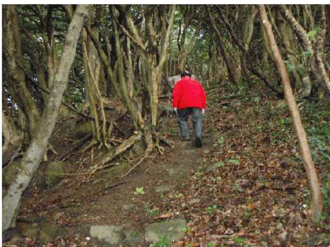
⑦傾斜が急な上、土砂や枝葉が階段に堆積し、また踏面が傾いているところもあり、滑りやすくなっている。
