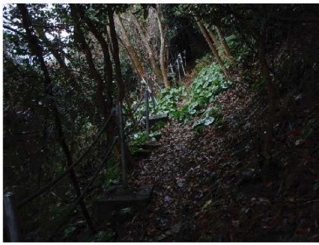
②斜面が崩れ、既存の手摺りが破損している
