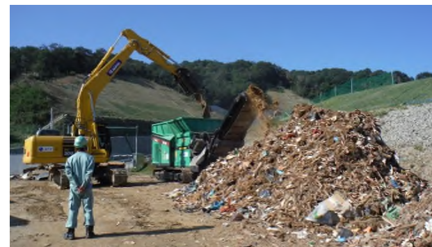
玖谷埋立地内の移動式破碎機
