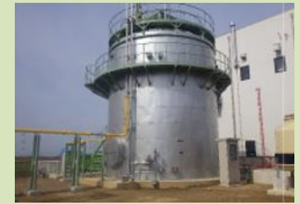
下水道施設におけるバイオメタン発酵事業
