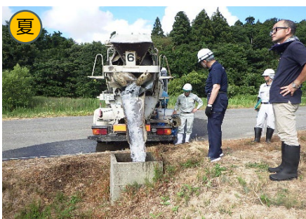
農業用水路への給水状況
