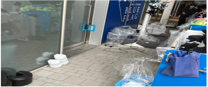
入口付近の排水溝（溢水箇所）
