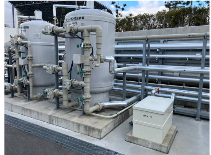
海水ろ過装置・井戸ポンプ
