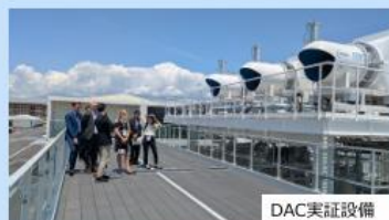
DAC実証設備
