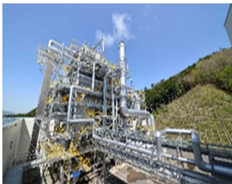
既存の木質バイオマス発電所
