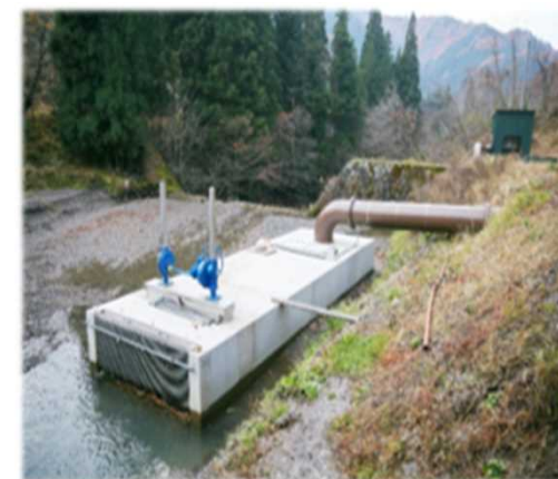
小水力発電施設
