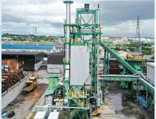
▲バイオマス発電プラント
