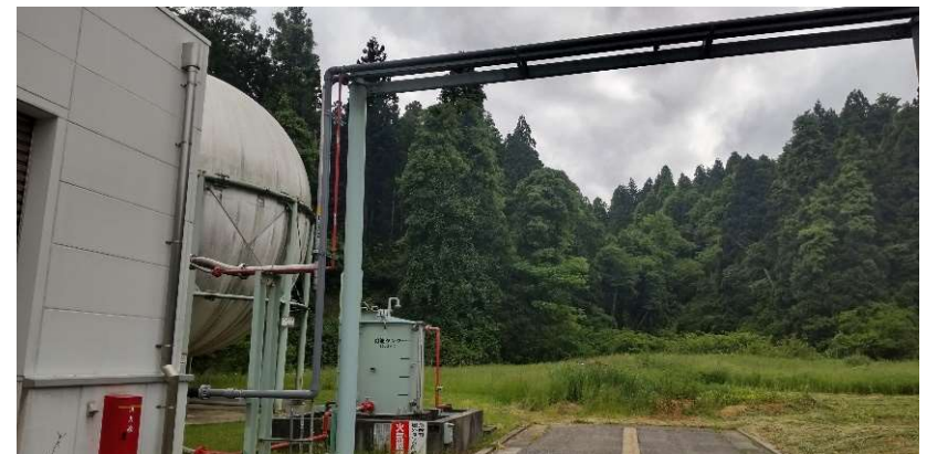
貯留槽から処理槽に仮配管し、し尿のみ処理
