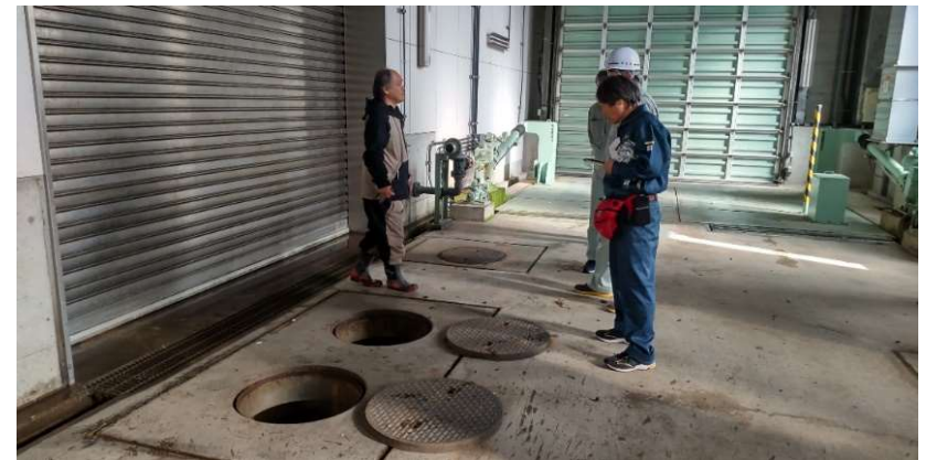
浄化センター貯留槽にし尿等を一時貯留
