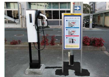
EV用充電器 / 福岡地方合同庁舎 (写真提供元: タイムズ24株式会社)
