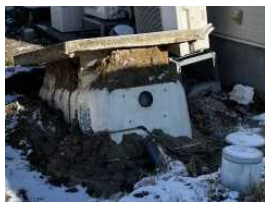
地震により浮き上がった浄化槽 (画像は七尾市内の例)
