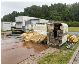
破損した浄化槽（清掃済）3基
