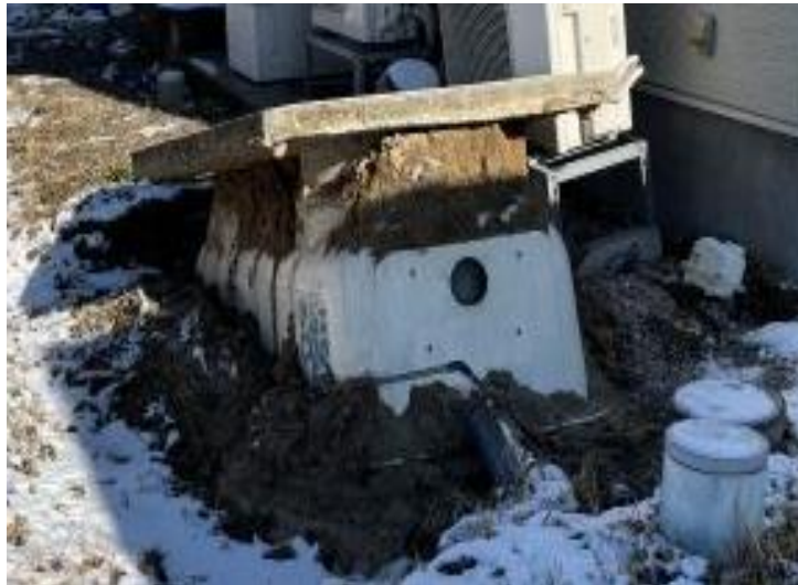
地震により浮き上がった浄化槽（画像は七尾市内の例）
