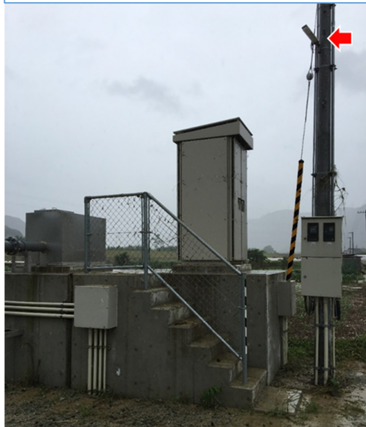
深井戸 動力盤 罹災後 【平成30年7月8日(日) 10時22分 撮影】
