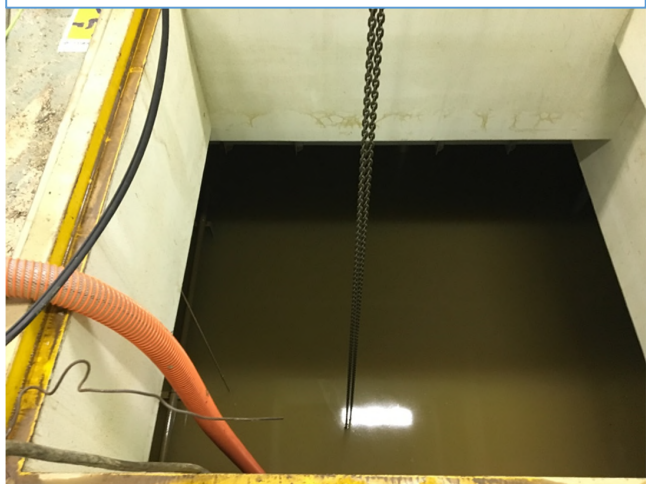
地下ポンプ室 排水状況 【平成30年7月11日(水) 22時19分 撮影】
