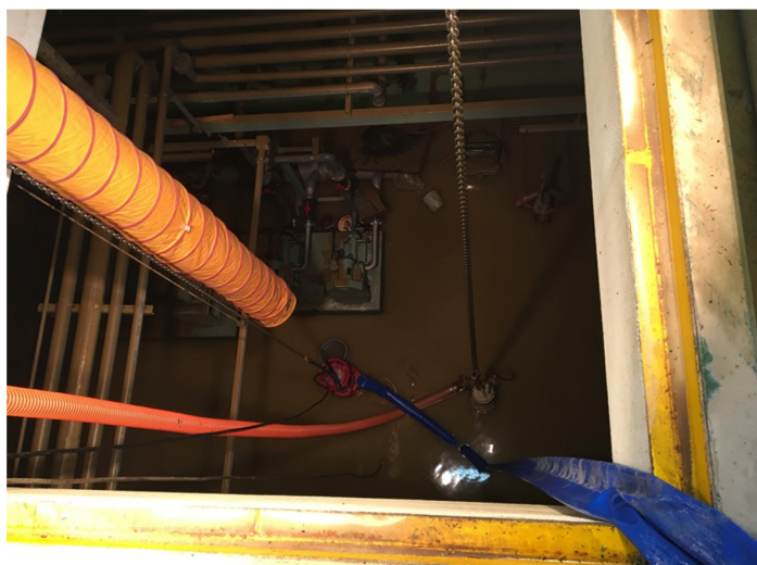
地下ポンプ室 排水状況(床面が見えるようになる) 【平成30年7月13日(金) 15時14分 撮影】
