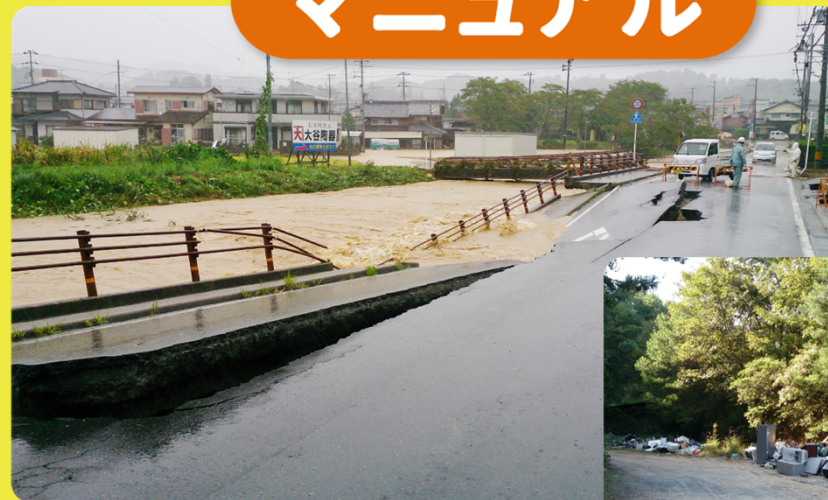
平成25年台風18号による被害状況
