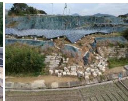
法面保護工が崩れて流出した事例
