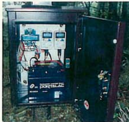
入下山カウンター内部の様子 (2方向の記録装置とバッテリー等)
