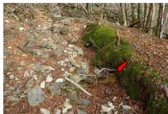
写真 4：洗掘が進行した調査地点 (S-8) 付近
