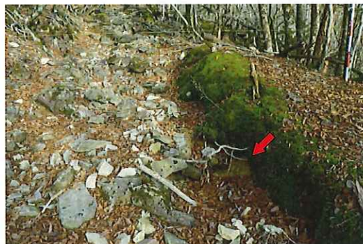
写真4：洗掘の進行が懸念された調査地点(S-8)付近
