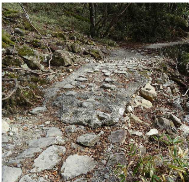
図 6-17 No.16 コンクリート歩道の谷側の 1/3 程度が崩れて、 下側に落ちる 歩道改良が必要
