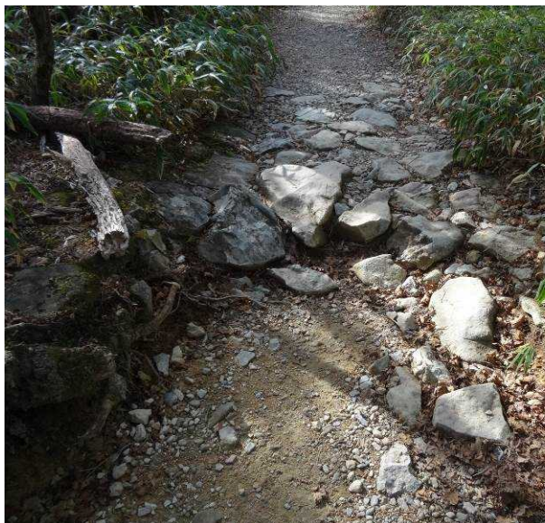
図 6-21 No.20 小さな段差 不整地運搬車の通行に問題なし
