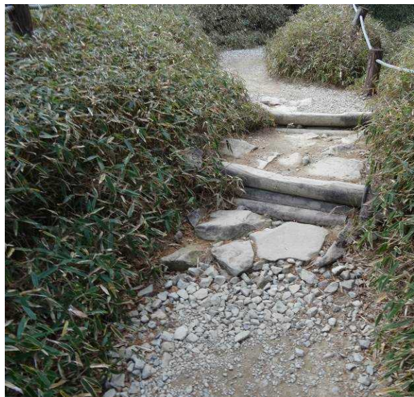
図 6-26 No.25 階段歩道 段差 30cm 程度
