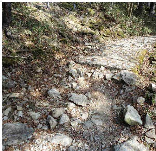
図 6-16 No.15 やや大きめの浮き石がみられた
