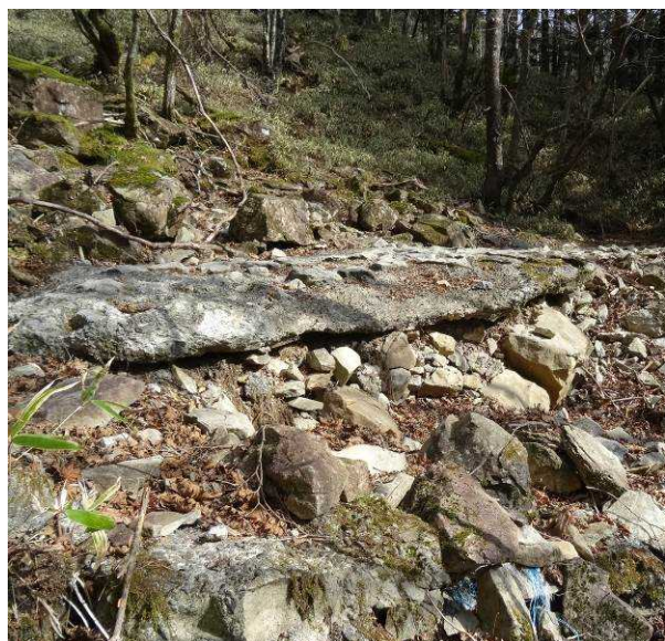
図 6-18 No.17 コンクリート歩道の下側が浮いている 歩道改良が必要
