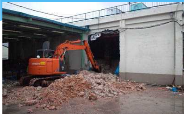
石巻市内水産加工場処理
