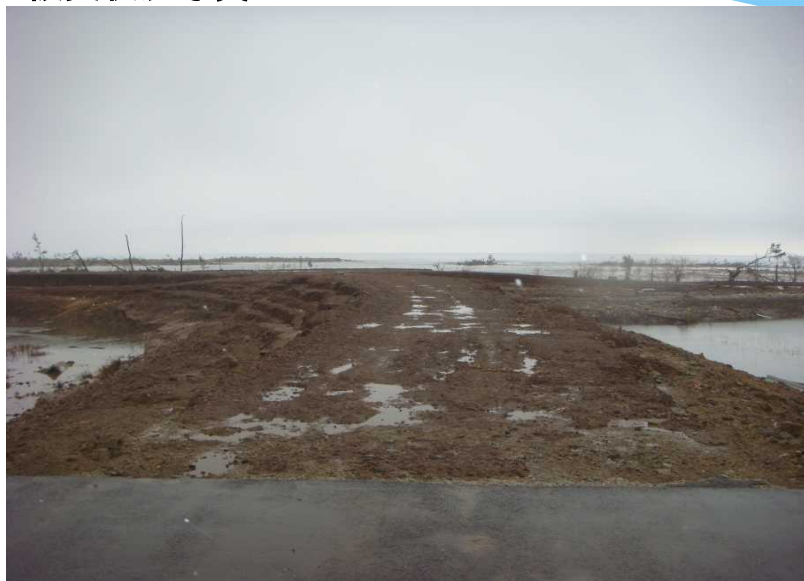
被災状況写真
